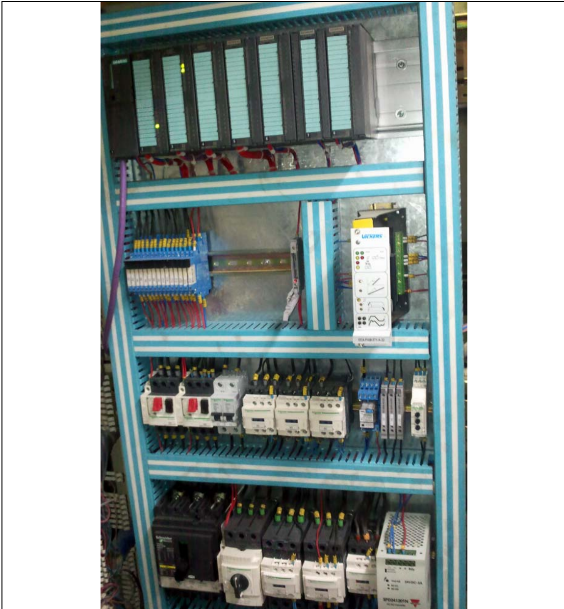
تابلوی کنترل سیستم هیدرولیک دستگاه ریکلایمر - صنعت سیمان
