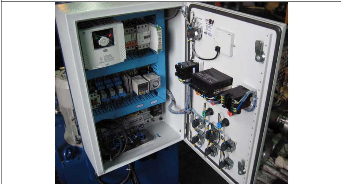
تابلوی کنترل یونیت فلاشینگ سیستم هیدرولیک
