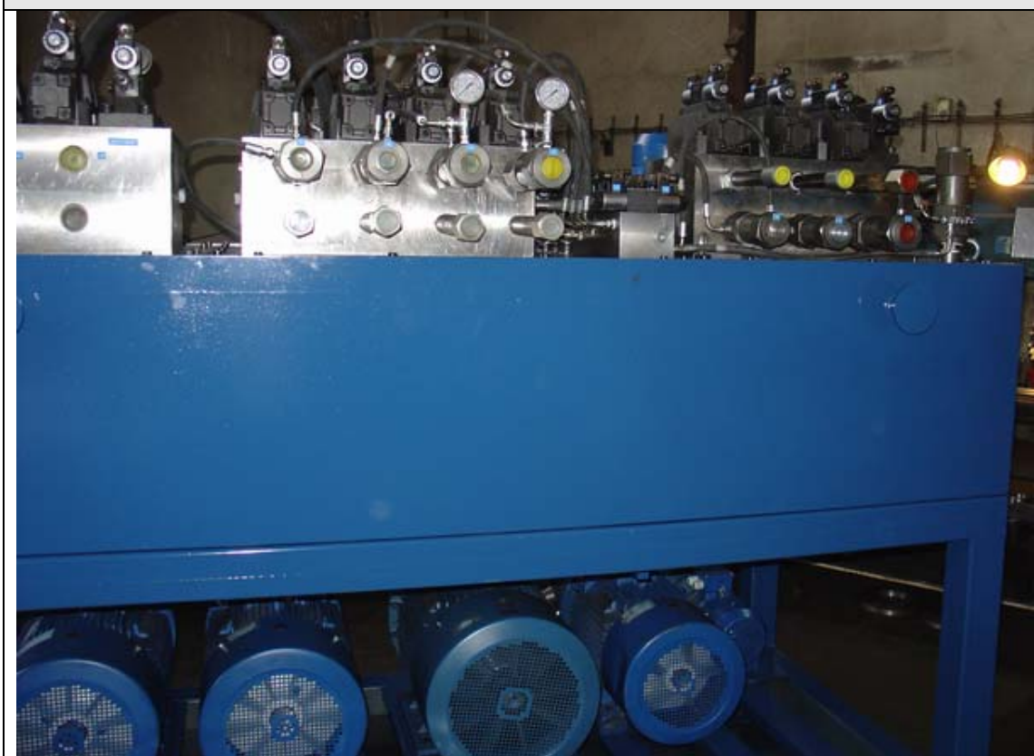
شیر های کنترل جهت برقی هایدمک
