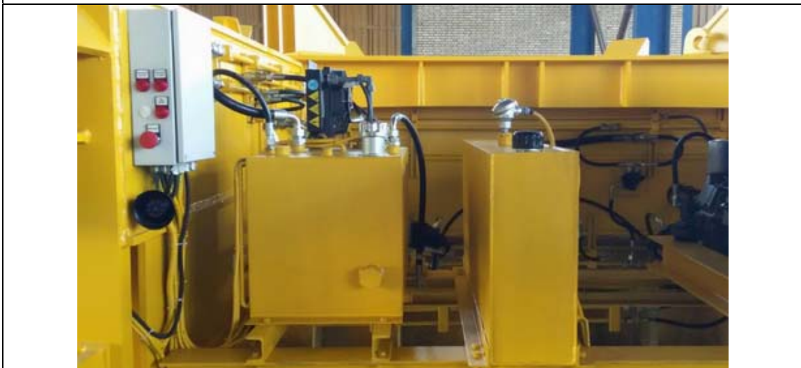
نصب Level Switch و ترموستات بر روی مخزن روغن
