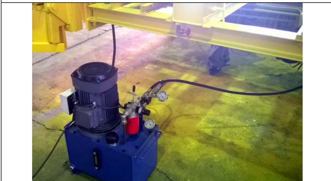
اعمال فشار 280bar و بررسی وجود نشتی از لوله ها ، اتصالات و شلنگها
