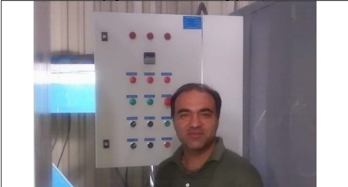
تابلوی کنترل یونیت هیدرولیک شامل PLC S7-200 زیمنس
